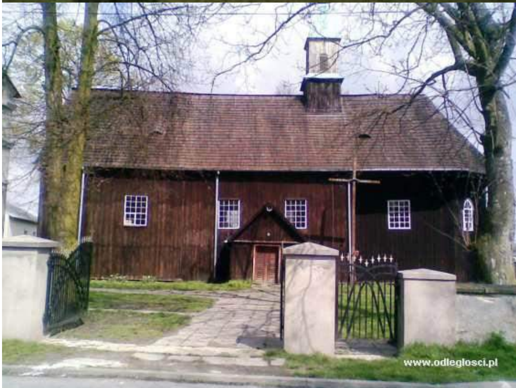
Fot.1,2 Zdjęcia archiwalne z 2008 roku , Stan okien przed wymianą. Jedynie okna prezbiterium
